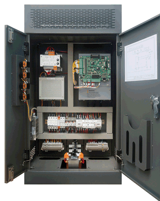
Tủ điện ngoại nhập Fuji - Malaysia Công nghệ Japan
