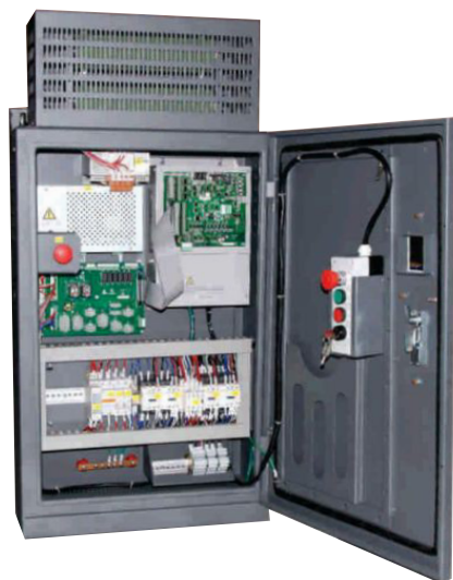
Tủ điện ngoại nhập Nippon - Malaysia
